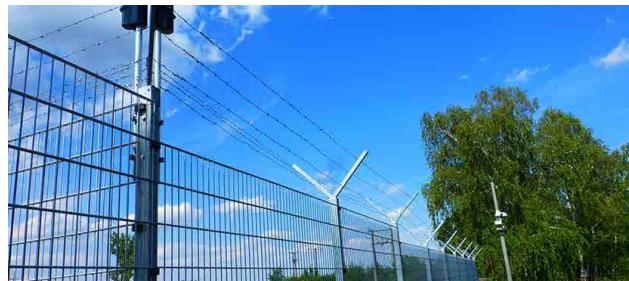
Системы охранно-тревожной сигнализации и защиты периметра
