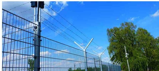
Системы охранно-тревожной сигнализации и защиты периметра
