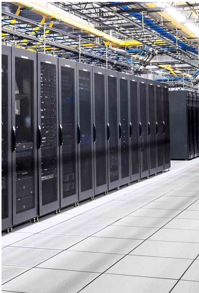
Решения на базе ИСБ КОДОС для обеспечения безопасности ЦОД
